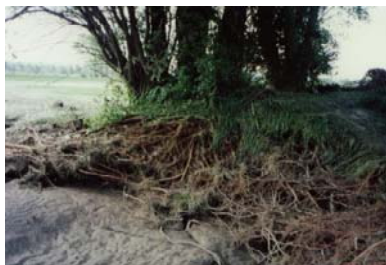
Deichbruch an der Ammer während Hochwasser 1999 (Quelle: WWA Weilheim)
