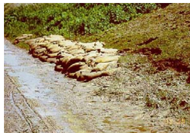
Erosion am landseitigen Deichfuß durch Sickerwasseraustritte - Sandsäcke zur Sicherung der Böschung Quelle: unbekannt
